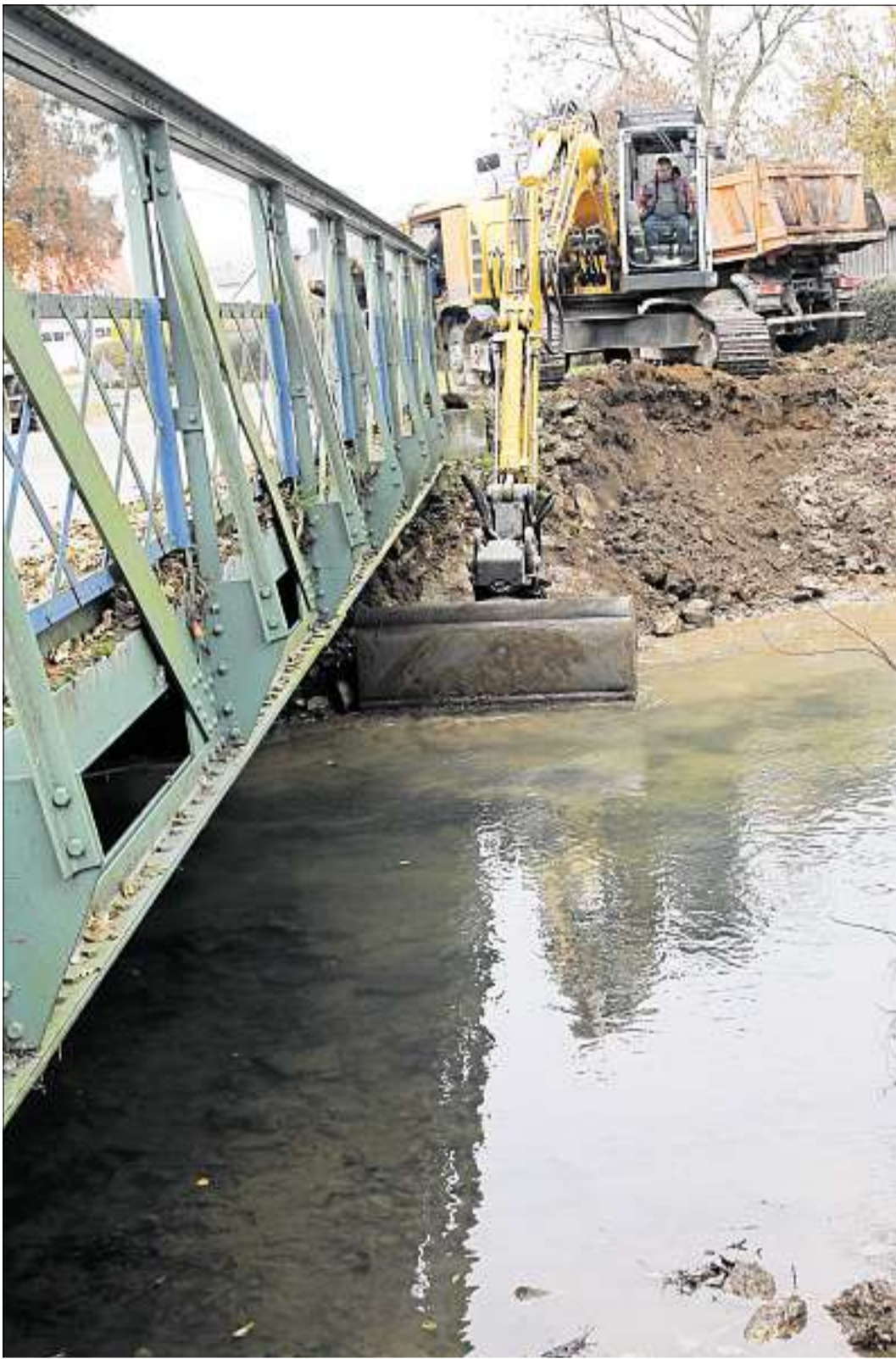
Beengte Verhältnisse: Auf relativ schmalen Raum musste der Bagger gestern arbeiten, um den Uferbereich bei der Espanbrücke auszuweiten. Dadurch soll im Fall eines Hochwassers an dieser Stelle ein Rückstau der Fluten verringert werden. Foto: Meßner
